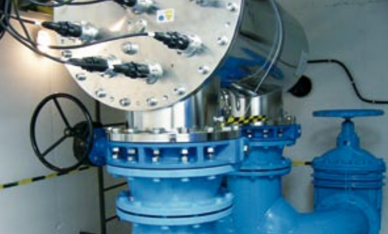
A Budaújilaki gépház 2004-ben átadott UV-vízkezelője
